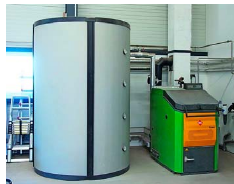
/ Geheizt wird mit eigenen Abfällen im Festbrennstoffkessel Euro 50 von HDG (50 kW). Der Warmwasserspeicher (3500 l) speist die Fußbodenheizung.
